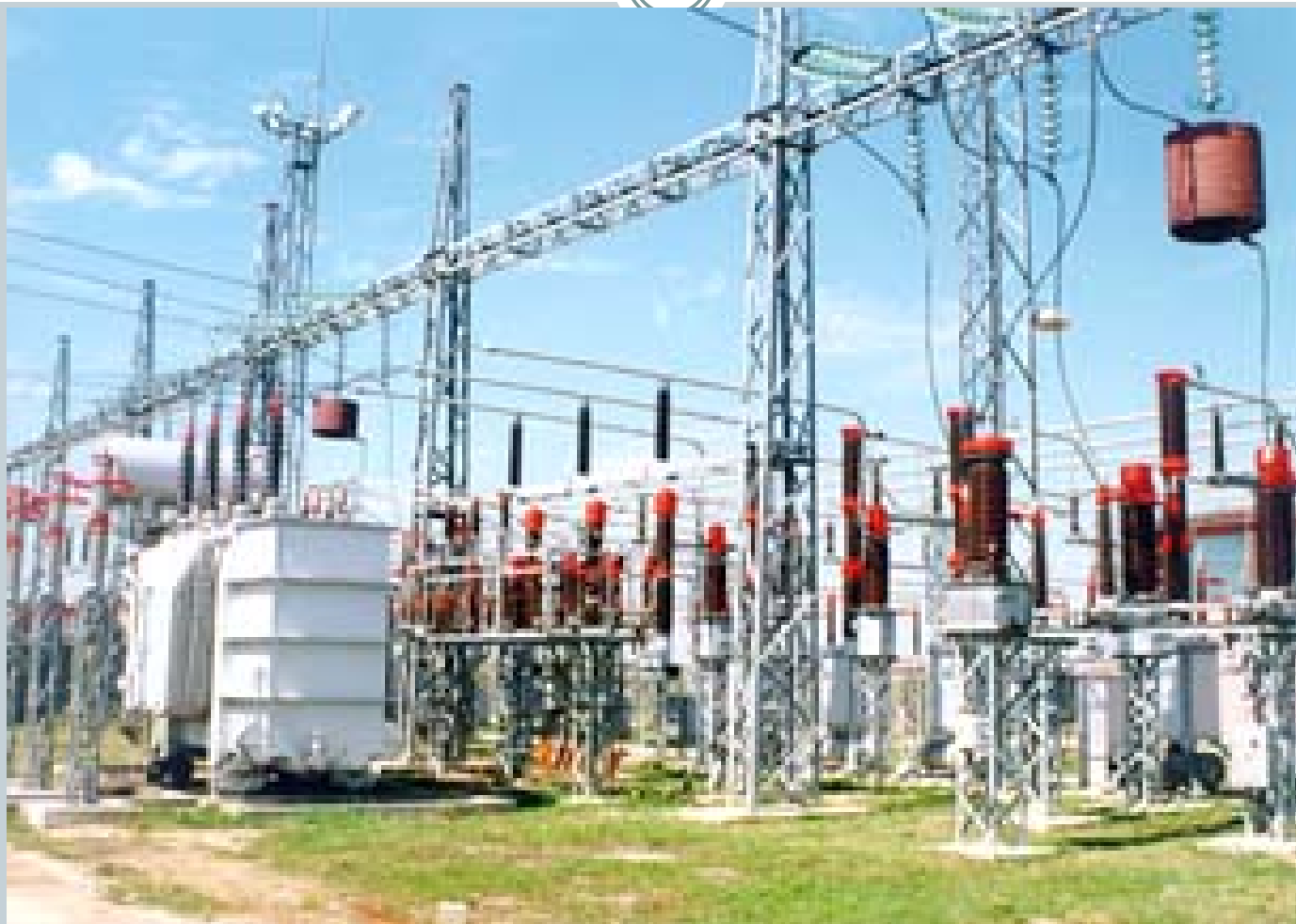
Slika 7 Transformatorska stanica na otvorenom prostoru
