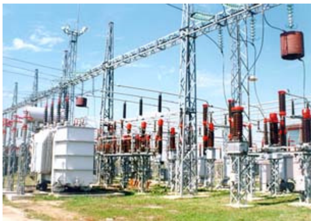
Slika 4-9 Transformatorska stanica na otvorenom prostoru
